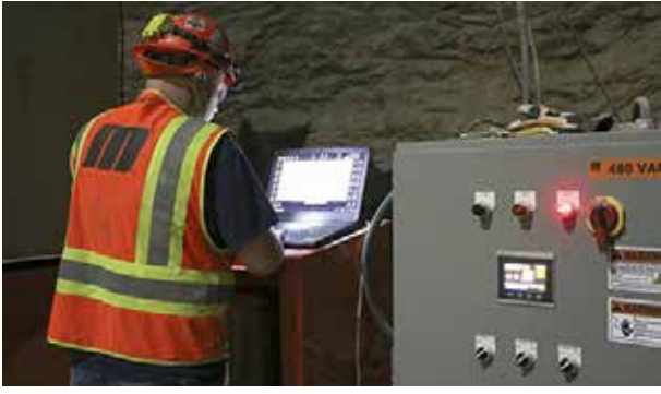
Resim 2. Sistemi tesisin PLC'sine entegre etmek operatörlerin kimyasal çıkışı izlemesine ve ayarlamasına yardımcı oluyor. Figure 2. Integrating the system with the plant's PLC helps operators to monitor and adjust chemical outputs.
