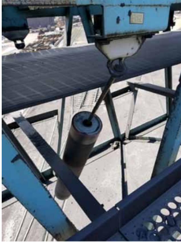
Arıza verene kadar çalıştırma yaklaşımı önemli güvenlik tehlikeleri yaratabilir A run-till-it-breaks approach can introduce significant safety hazards.
