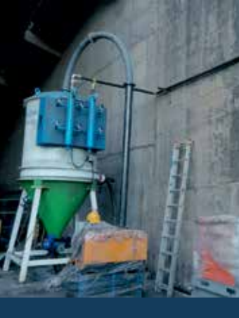
Vc126 Yüksek Vakum Ünitesi
