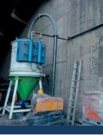
Vc126 Yüksek Vakum Ünitesi
