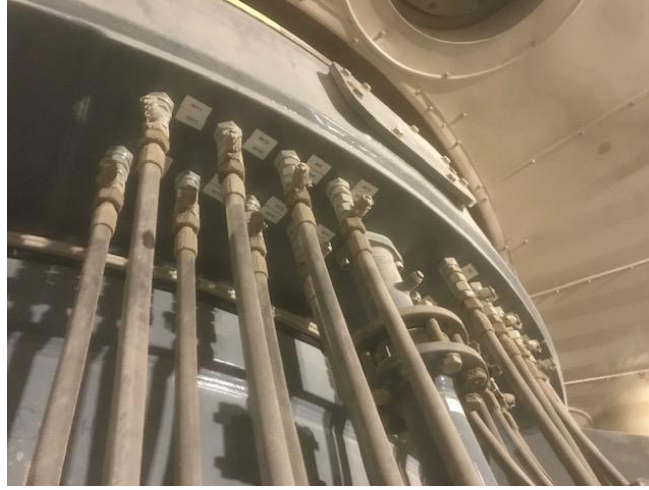
Resim 6- Hidrolik ünite kontrolü
